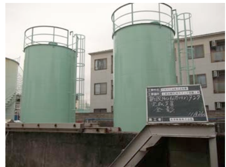
屋外タンク貯蔵所
